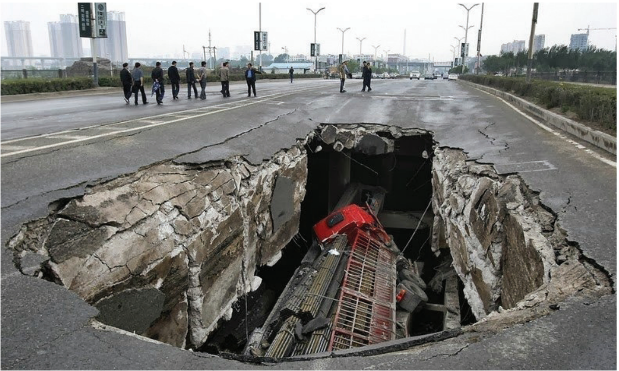
Şekil 4. Chanchun (Çin) şehrinde oluşan yüzey çökmesinin yaptığı hasar (Google taraması).
